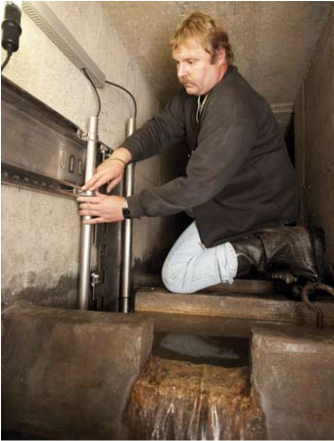
Installation von Messeinrichtungen für elektronische Datenabfragen in einer Quellfassung.
