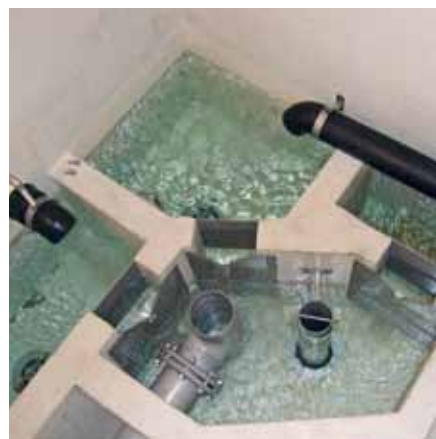
In der Brunnenstube einer Quellfassung wird das Wasser aus den Sickerleitungen gesammelt.
