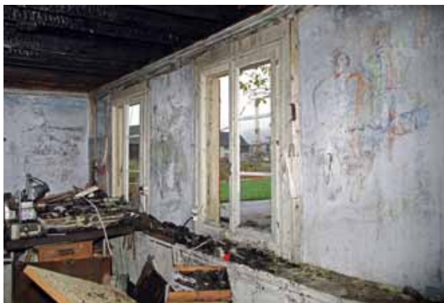
Gleich mehrere Brände an Schutzobjekten waren im Jahr 2012 zu beklagen. In Niederbüren gingen durch einen Brand Kreidezeichnungen von internierten Polen aus dem 2. Weltkrieg verloren. Foto Kant. Denkmalpflege.
