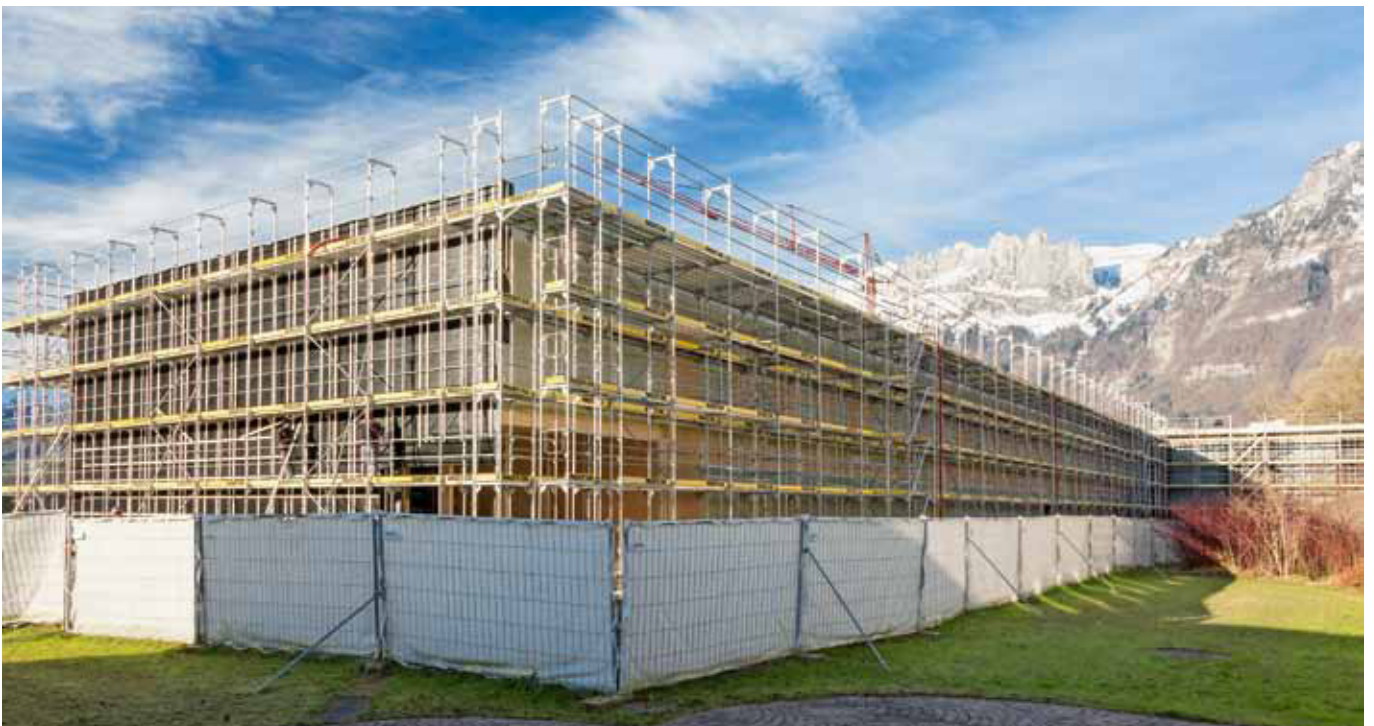
Der nachhaltige Holzrohbau des neuen Hauptgebäudes in Salez steht für den Innenausbau bereit. (Bild: Daniel Luther)
