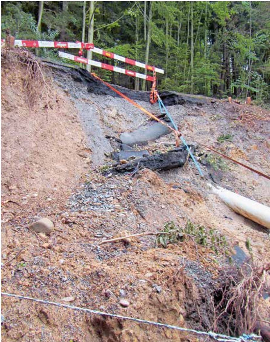
Unwetterschaden an der Dörflerbergstrasse in Rufi
