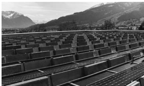
Blick auf die Photovoltaikanlage auf dem Dach des Schulhauses Höfli
